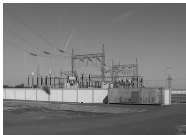
Fig. 15 – Infrastrutture elettriche per il trasporto dell'energia a Matam (foto: Quatrada D., febbraio 2006)
