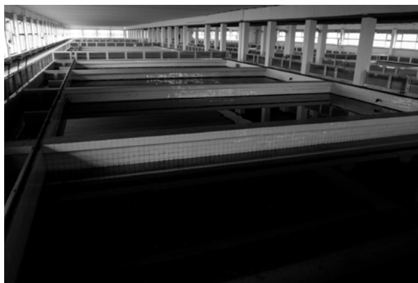
Fig. 8 – Impianto di trattamento dell'acqua potabile di Bistriza (foto: Brusarosco A., 2008).
